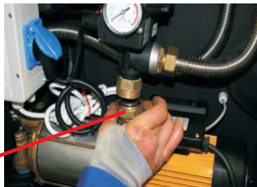
Druckstutzen der Pumpe
