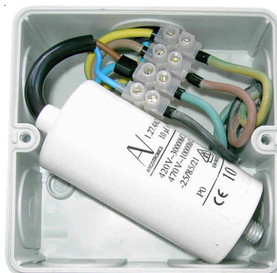
Bild 7: Verteilerdose mit angeklammtem Kondensator
