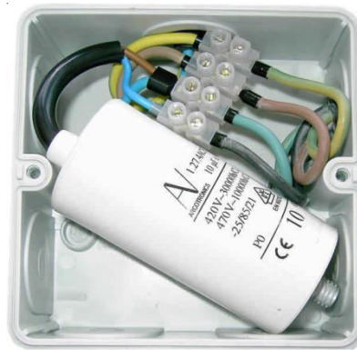
Bild 7: Verteilerdose mit angeklammertem Kondensator
