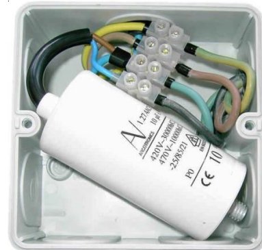
Bild 7: Verteilerdose mit angeklammtem Kondensator
