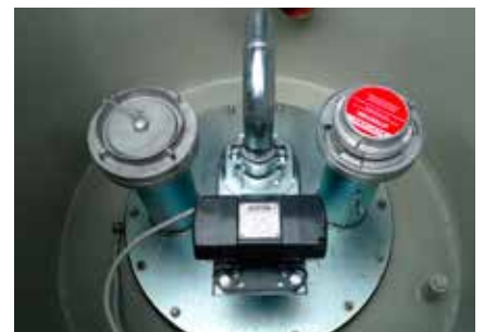
6 | Pelletentnahmelanze im fertig eingebauten Zustand. Tank ist bereit für die Befüllung.
