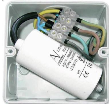
Bild 7: Verteilerdose mit angeklammtem Kondensator
